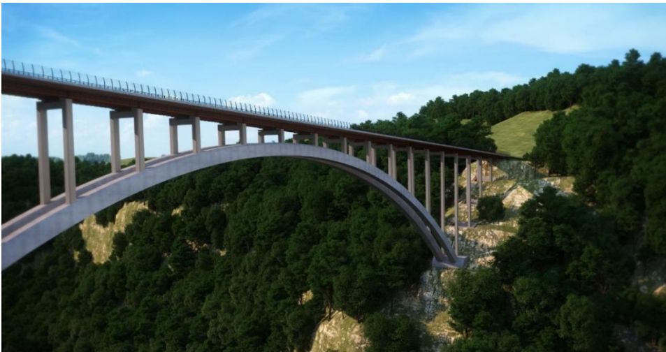
სურ. 1.3.12. 500 მ. სიგრძისა და 300 მ სიმაღლის თაღოვანი მშენებარე ხიდი ხადას ხეობაში ( https://kveshetikobiroad.ge/ )
